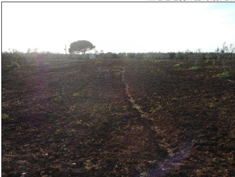
29. Mesagne (BR), località Suppenna-Masseria Epifani, nuovo tracciato del metanodotto visto da E.
