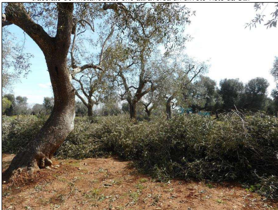
76. Francavilla Fontana (BR), Strada Provinciale 26 Ceglie Messapica-Francavilla Fontana, nuovo tracciato del metanodotto che attraversa un uliveto visto da NW.
