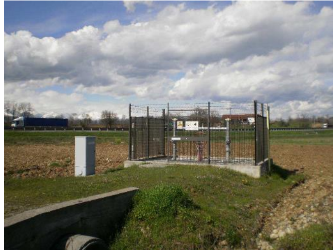
Figura 1. 14 - Esempio di impianto di intercettazione di linea PIL
