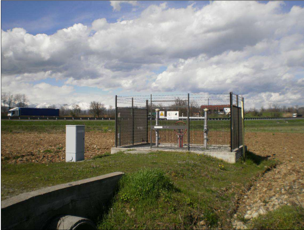
Figura 5.1 - Esempio di impianto di intercettazione di linea PIL
