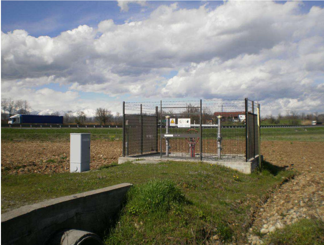
Figura 5.10 - Esempio di impianto di intercettazione di linea PIL.
