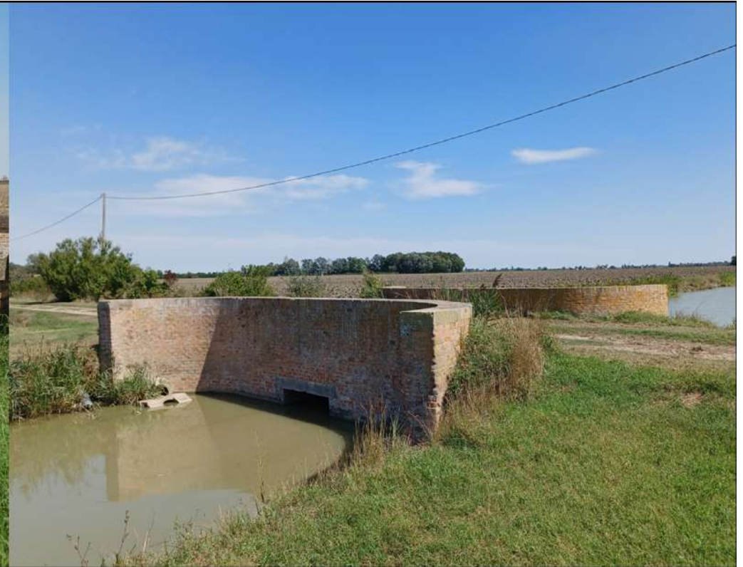
Ponte non idoneo lato nord
