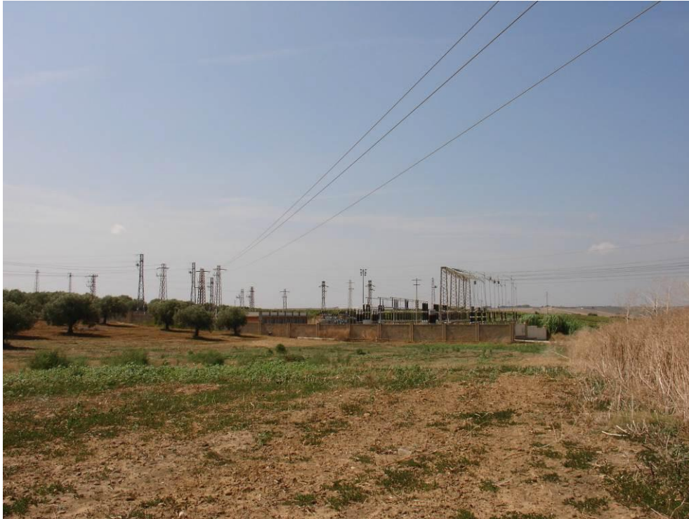
Fig. 16 Cabina di consegna di un parco eolico
