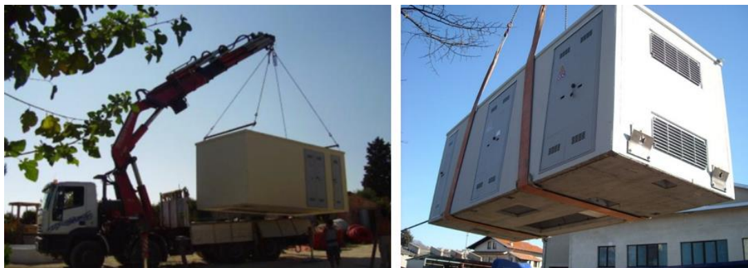
Figura 36: Fornitura e posa in opera delle cabine di raccolta e delle Power Station
