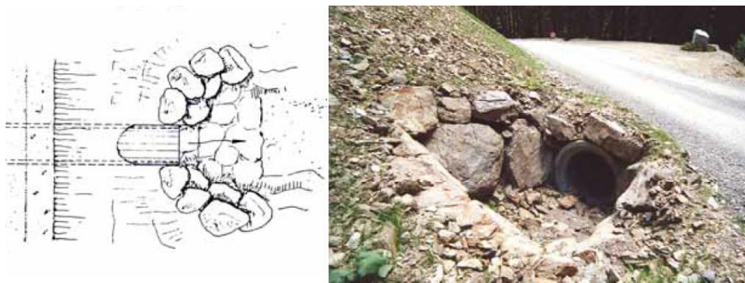
Figura 6.15: Pozzetti in legname e in massi (fonte: "Viabilità forestale regionale" Bortoli, P.L. 2001).
