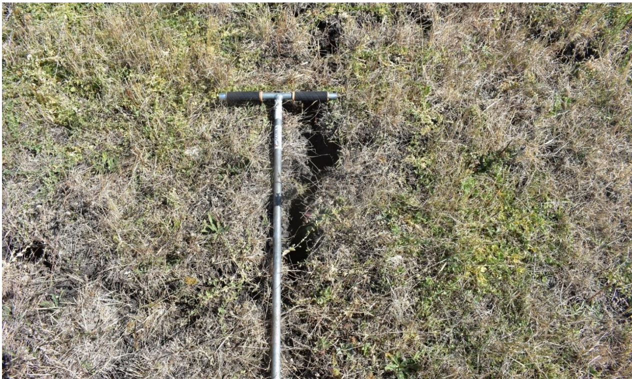
Figura 3.44 – Altra immagine delle fessurazioni superficiali a valle del sito rilevato
