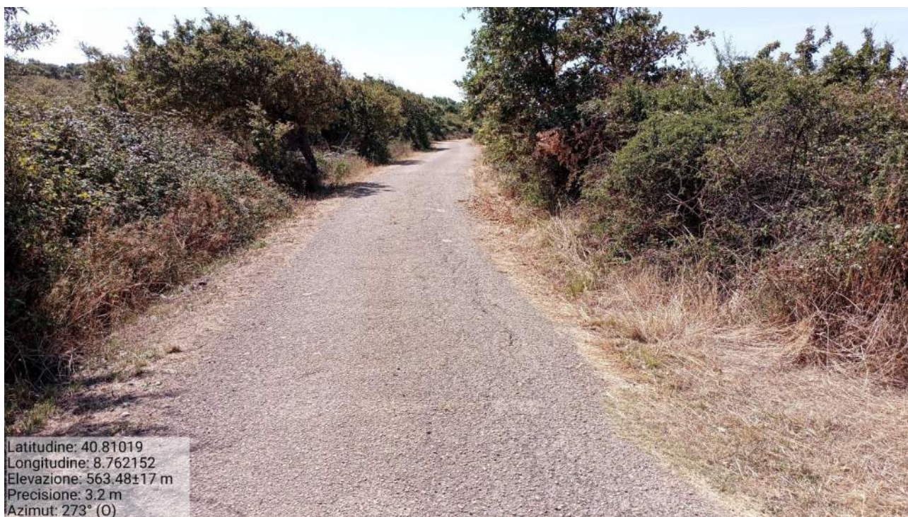
Figura 5.34 – Viabilità campestre in adeguamento di collegamento alla postazione T08 facente parte della viabilità di progetto (direzione ovest)
