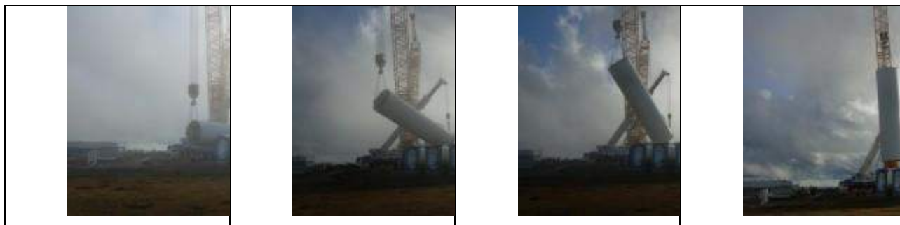
Figura 5.70 – Schema delle fasi di sollevamento dei componenti dell'aerogeneratore (Fonte sito web http://www.windfarmbop.com/ )
