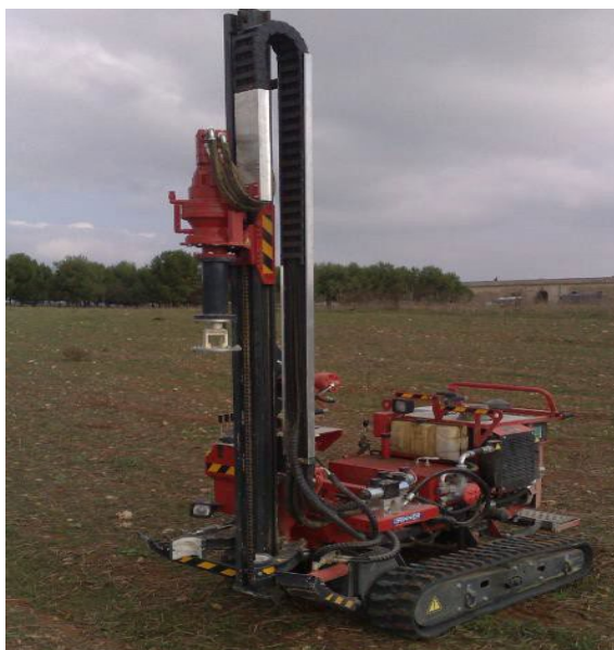
FIGURA 36 - MACCHINA BATTIPALO PER INFISSIONE PALI.
