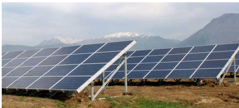
Figura 3- Installazione con 4 moduli in orizzontale su struttura fissa
