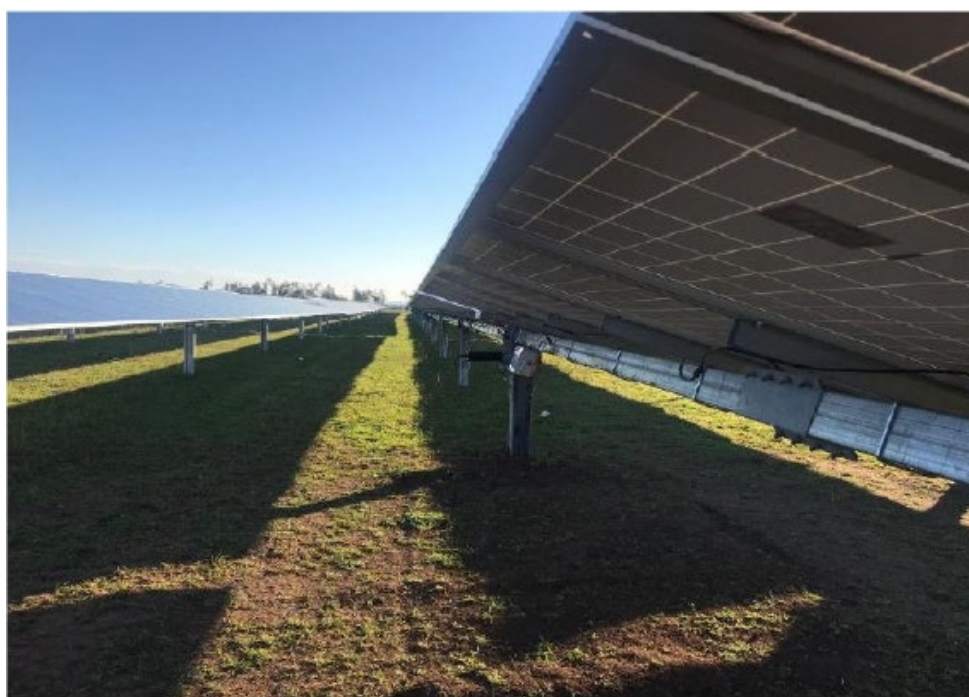
Figura 35. Esempio di impianto fotovoltaico realizzato con supporti costituiti da pali in acciaio infissi direttamente nel terreno
