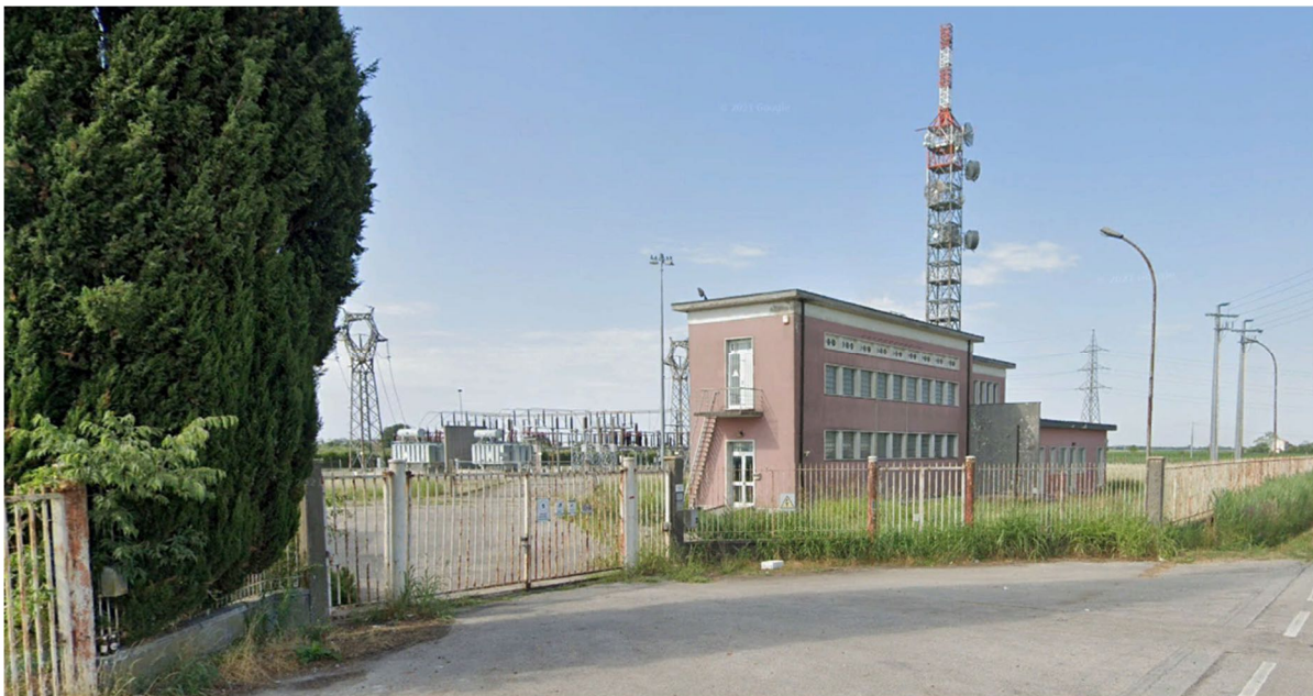
Figura 7 - Cabina Primaria "Caorle" 132 / 20 kV
