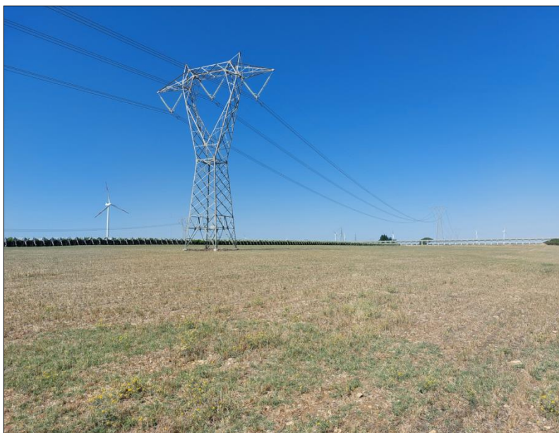
FIGURA 1.1 TRALICCI E LINEE AT PRESENTI NELL'IMPIANTO
