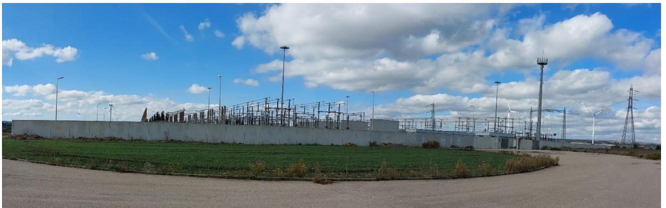
Stazione Elettrica Terna
