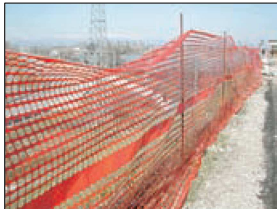
Situazione non regolare: la rete non è sufficiente per proteggere dalla caduta dal ciglio dello scavo
