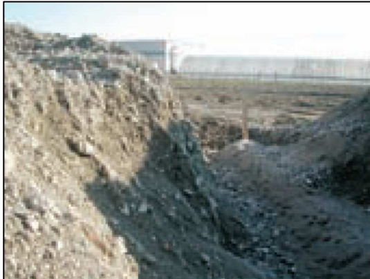
Situazione non regolare: dal fronte dello scavo possono cadere dei sassi
