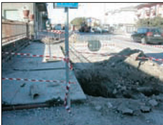
Situazione non regolare: il solo nastro non è sufficiente per proteggere dalla caduta nello scavo
