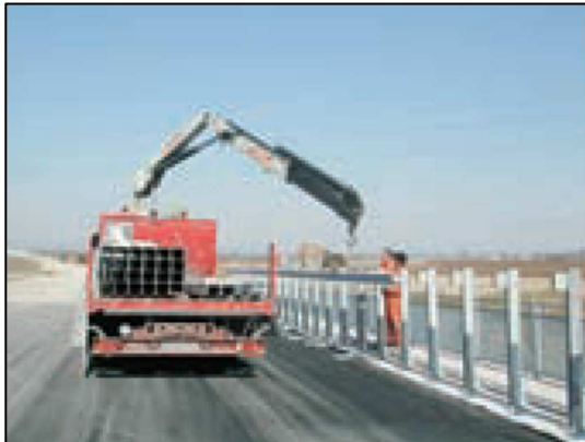
Situazione non regolare: i lavoratori sono privi di casco e il gancio dell'autogrù è privo di sistema anti-sganciamento
