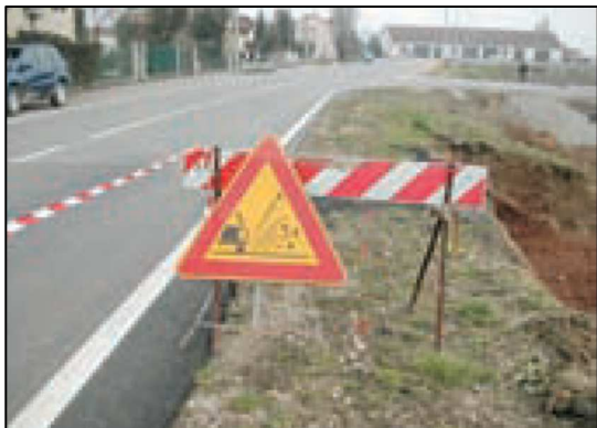
Situazione regolare: il ciglio della strada è pulito ed è presente idonea segnaletica
