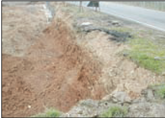
Situazione non regolare: il fronte dello scavo non è inclinato e può franare; non ci sono segregazioni dell'area alla base e sul ciglio dello scavo
