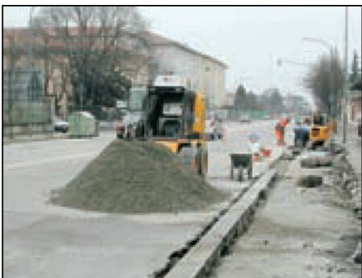
Situazione non regolare: manca la recinzione di cantiere
