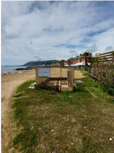
Stazione di sollevamento nell'Arenile Nord
