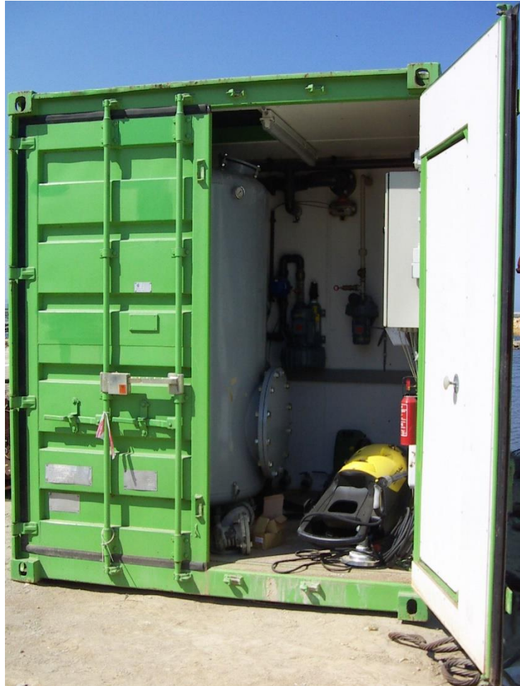
Figura 8 Container con quadro di controllo dell'impianto di trattamento
