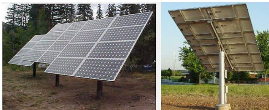
Figura 3.1-2 Inseguitori di Tilt
