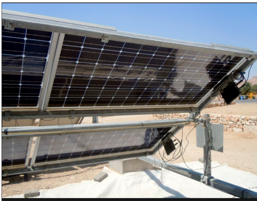
Fig. 5.1-1 Tipico Modulo fotovoltaico Bifacciale
