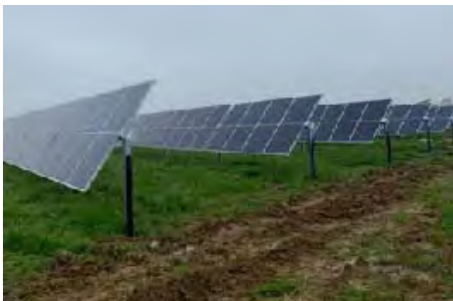
Foto 8 - Impianto fotovoltaico con pannelli ad inseguimento
