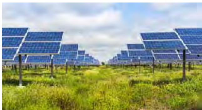
Foto 10- Impianto fotovoltaico con pannelli ad inseguimento
