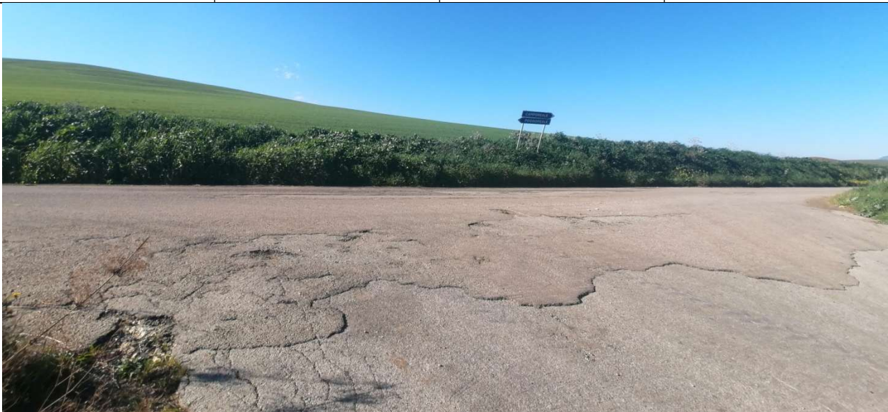
Tratto del cavidotto su SP20
