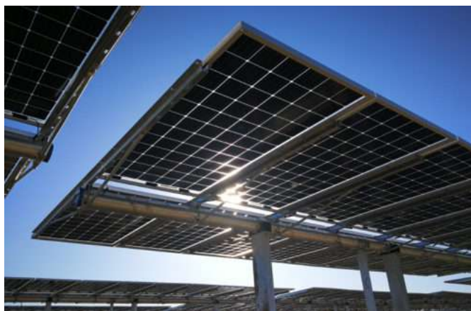
Figura 2.42 Esempio di struttura a tracker monoassiale
