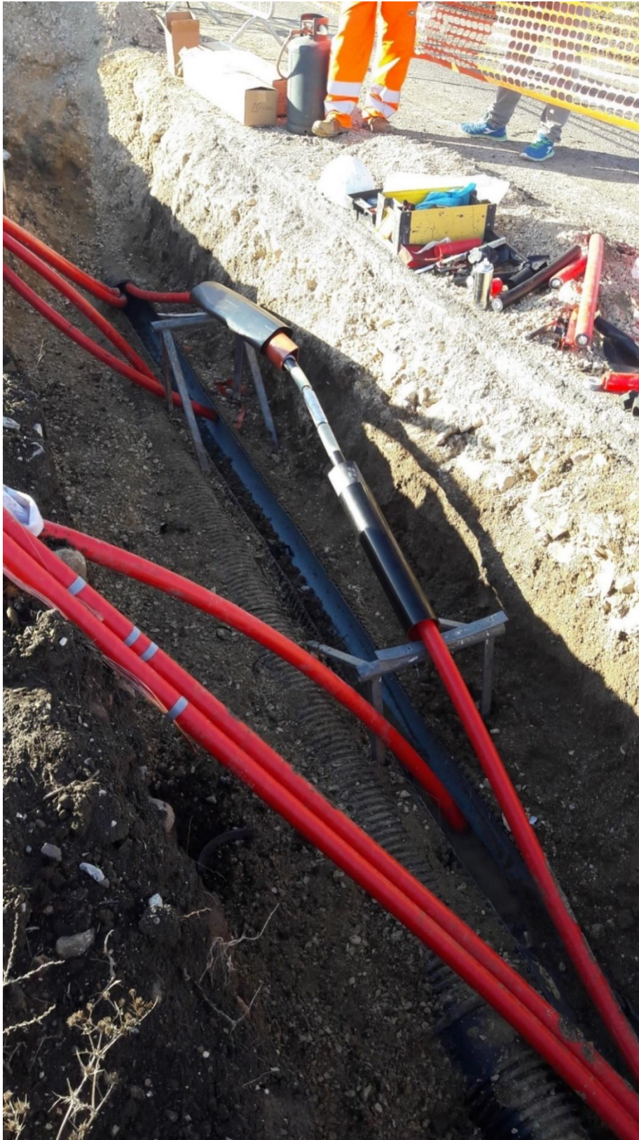
Figura 8_ Individuazione e sostituzione giunto (giunto a caldo) – Impianto Eolico di Proprietà – Basilicata
