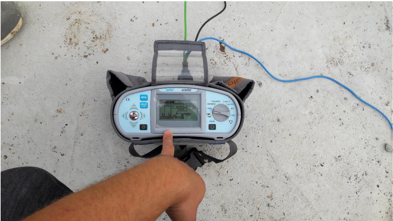
Figura 9_ Attività di verifica dello stato della rete di terra – Impianto Eolico di Proprietà – Basilicata
