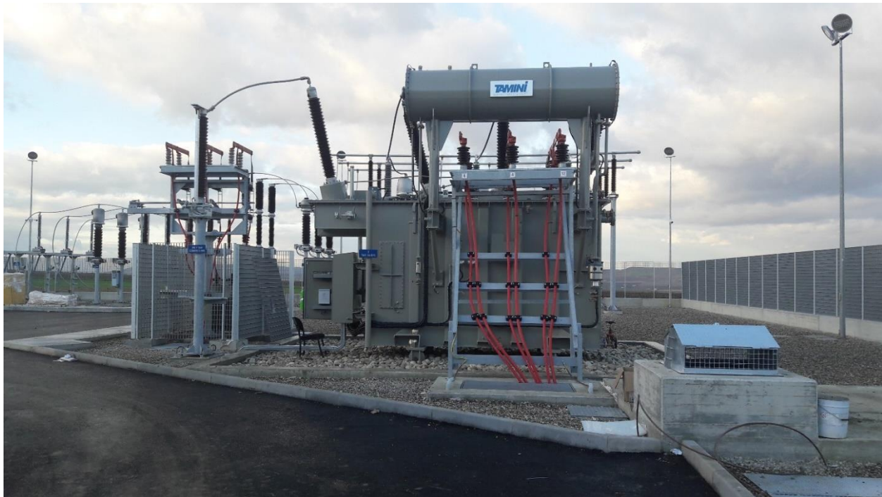
Figura 5_ Trasformatore MT/AT Parco Eolico di Proprietà (S.E. Melfi)
