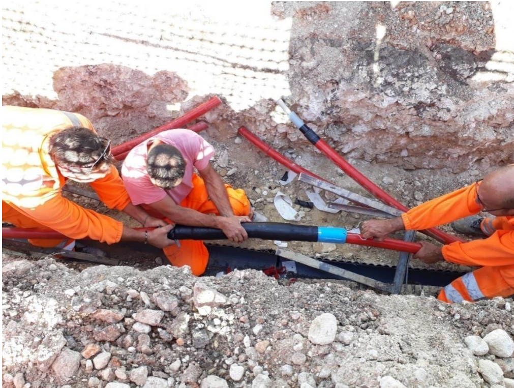
Figura 7_ Individuazione e sostituzione giunto (giunti a freddo) – Parco Eolico di proprietà - Puglia
