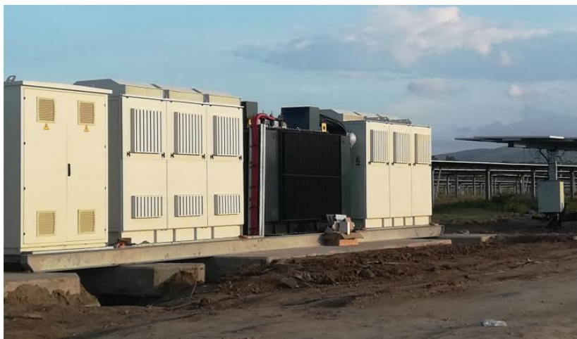
Figura 6 - Esempio skid conversione.
