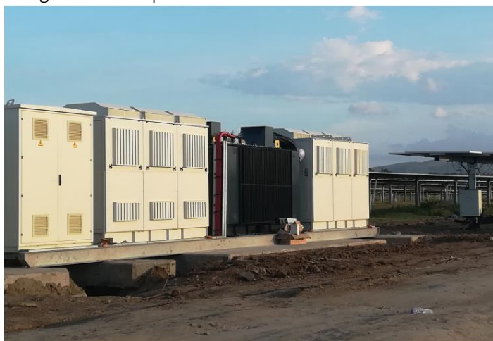
Figura 11 Esempio skid conversione
