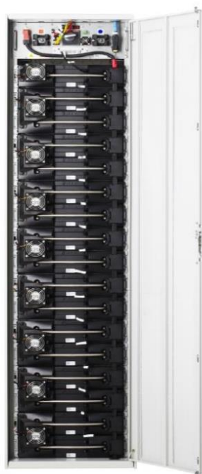
Figura 6 Esempio rack batterie
