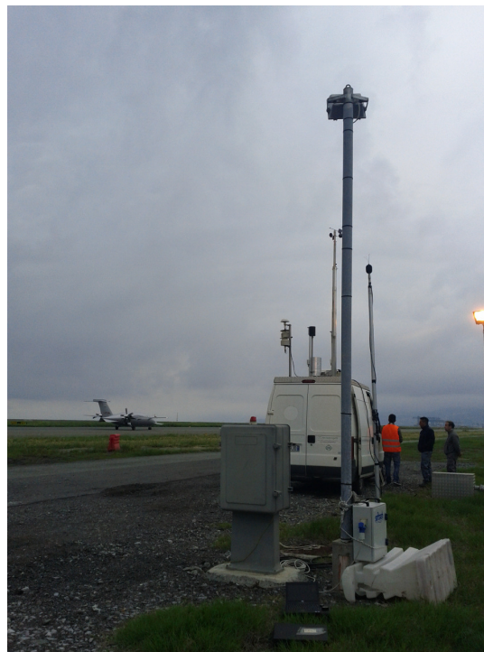
fig. 2: centralina (cabinet + palo microfonico)
