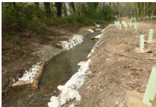
Figura 2.3.54: Intervento di diversificazione dell'alveo di un canale di connessione tra il fiume Oglio e una lanca laterale (Parco Regionale dell'Oglio nord, Comune di Pumenengo, Provincia di Bergamo)
