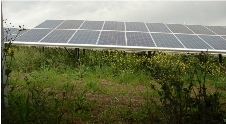
Figura 55 - Caso studio Parco Fotovoltaico "Villalba di Gesù" da 5 MW (Foto G. Filiberto)
