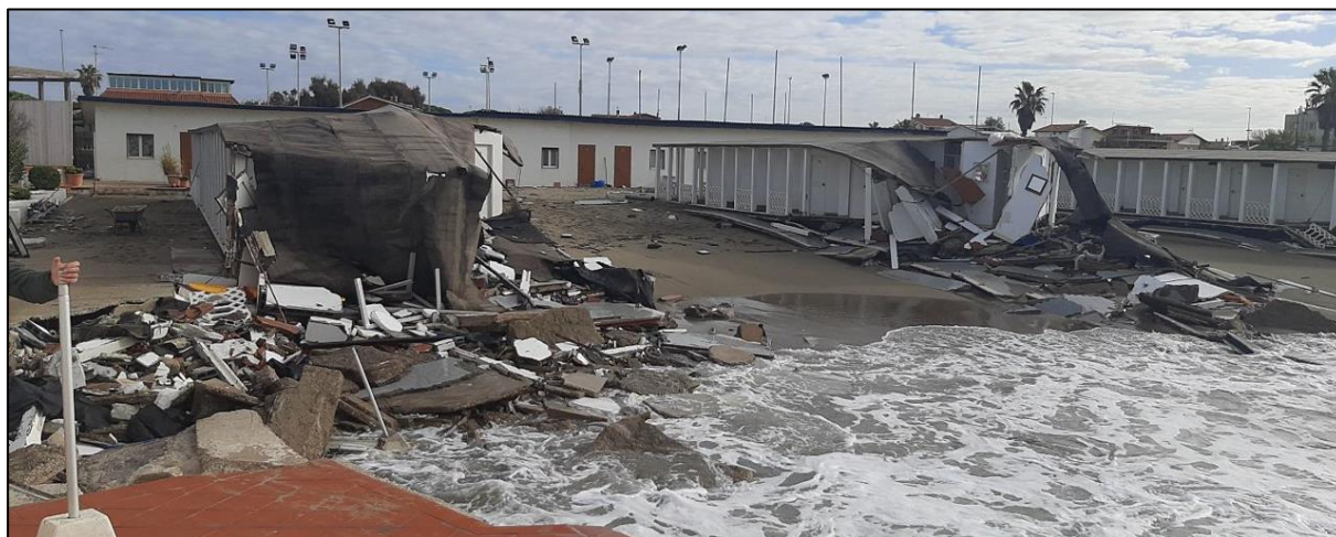
Figura 8.3: Crollo delle cabine de La Nave a seguito delle mareggiate dell'inverno 2022; foto n. 2.
