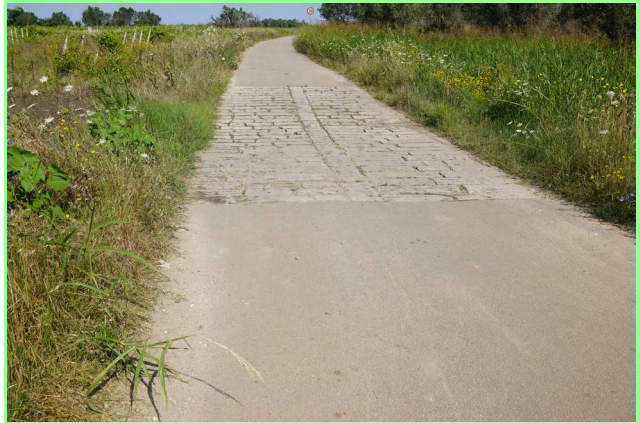
Figura 26: Area soggetta ad allagamento lungo il tracciato del cavidotto (Punto rilievo: W93).
