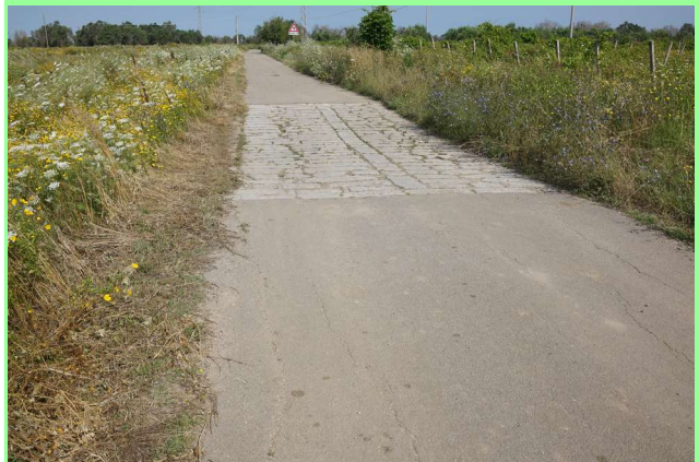
Figura 28: Area soggetta ad allagamento lungo il tracciato del cavidotto (Punto rilievo: W94).
