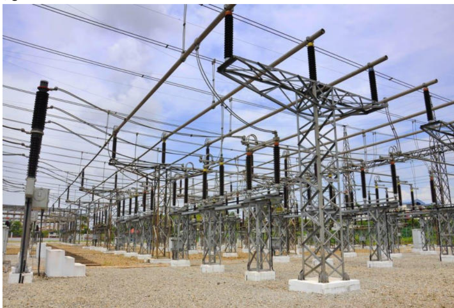
Figura 5-7 Esempio di sottostazione AT con equipaggiamenti installati su basamenti in c.a.
