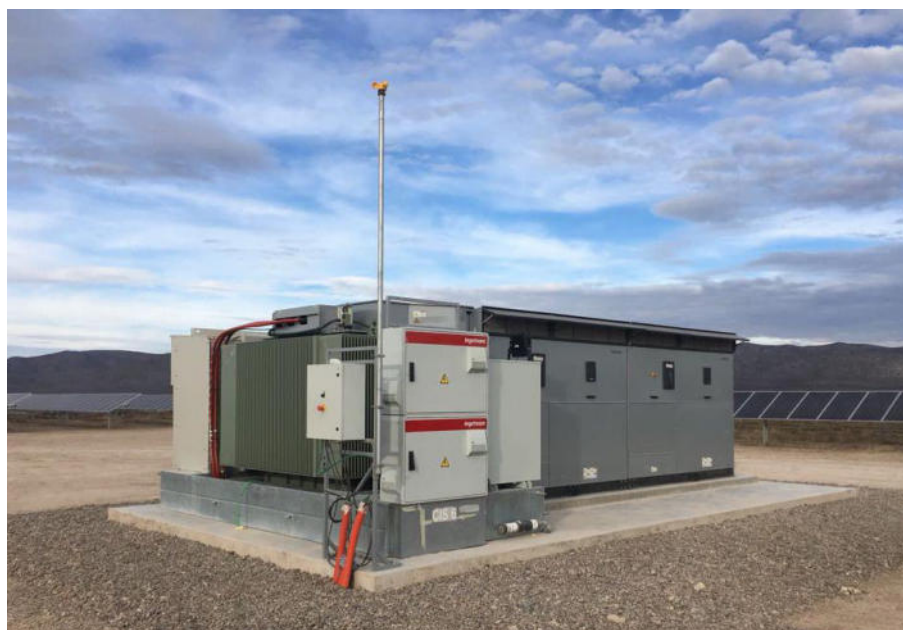
Figura 5-6 Esempio fotografico di inverter su basamento in c.a.
