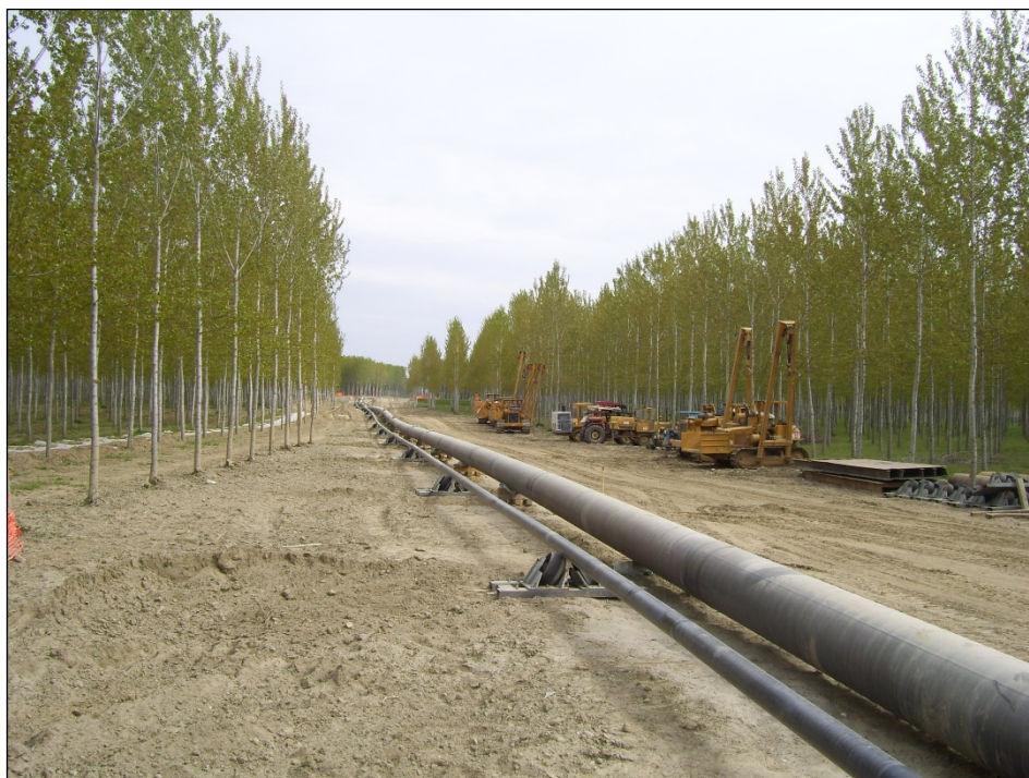
Attraversamento F. Po con met. 30" – Colonna del pipeline preassemblata sulla pista di varo
