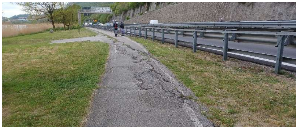
Figura 106 - Cedimento della pista ciclopedonale in vicinanza al rilevato della SS36.
