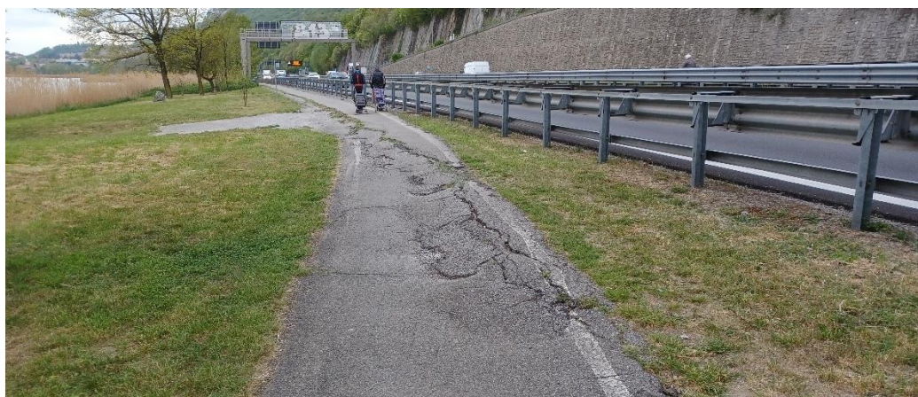
Figura 25 - Cedimento della pista ciclopedonale in vicinanza al rilevato della SS36.
