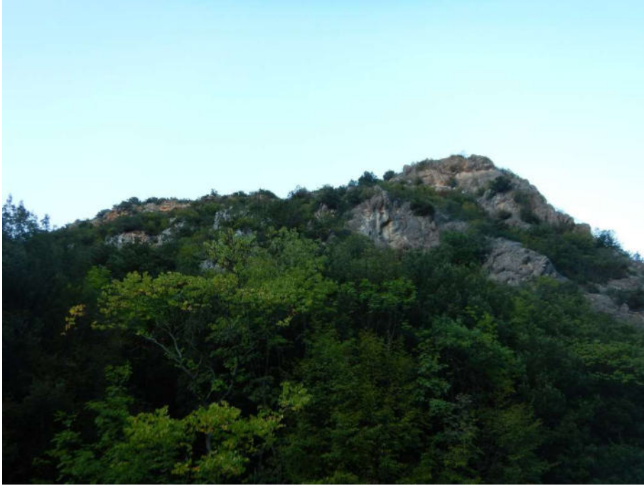
Figura 23 – Settore di fine tracciato (Pk 5+500 circa); pareti rocciose con alla base falda detritica vegetata a bosco.
