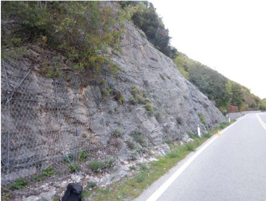
Figura 16 – Pareti rocciose riferibili Scaglia Rossa (Turoniano inferiore - Eocene medio) con possibile distacco di blocchi
