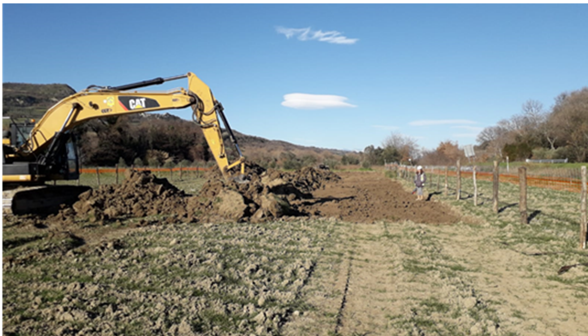
Fig. 9/A: Apertura pista di lavoro con accantonamento (a sinistra) dello strato superficiale di terreno (humus)
