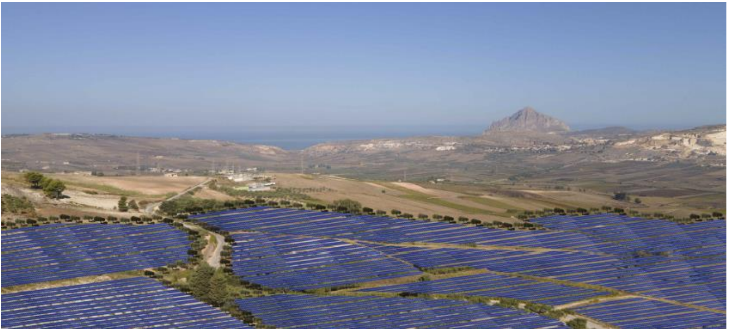
CONO B – stato POST operam impianto “Buseto 99”
