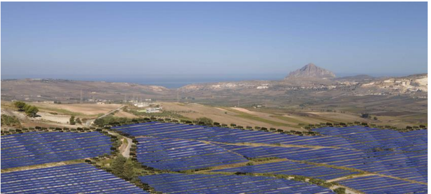
CONO B – stato POST operam impianto “Buseto 99”
