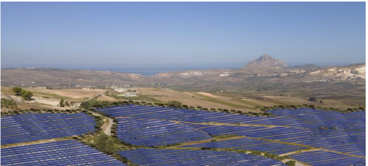
CONO B – stato POST operam impianto “Buseto 99”
