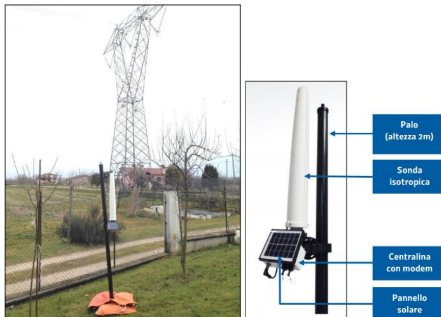
Esempio di installazione con ancoraggio a terra (a sinistra) e dettaglio della strumentazione di misura (a destra)
