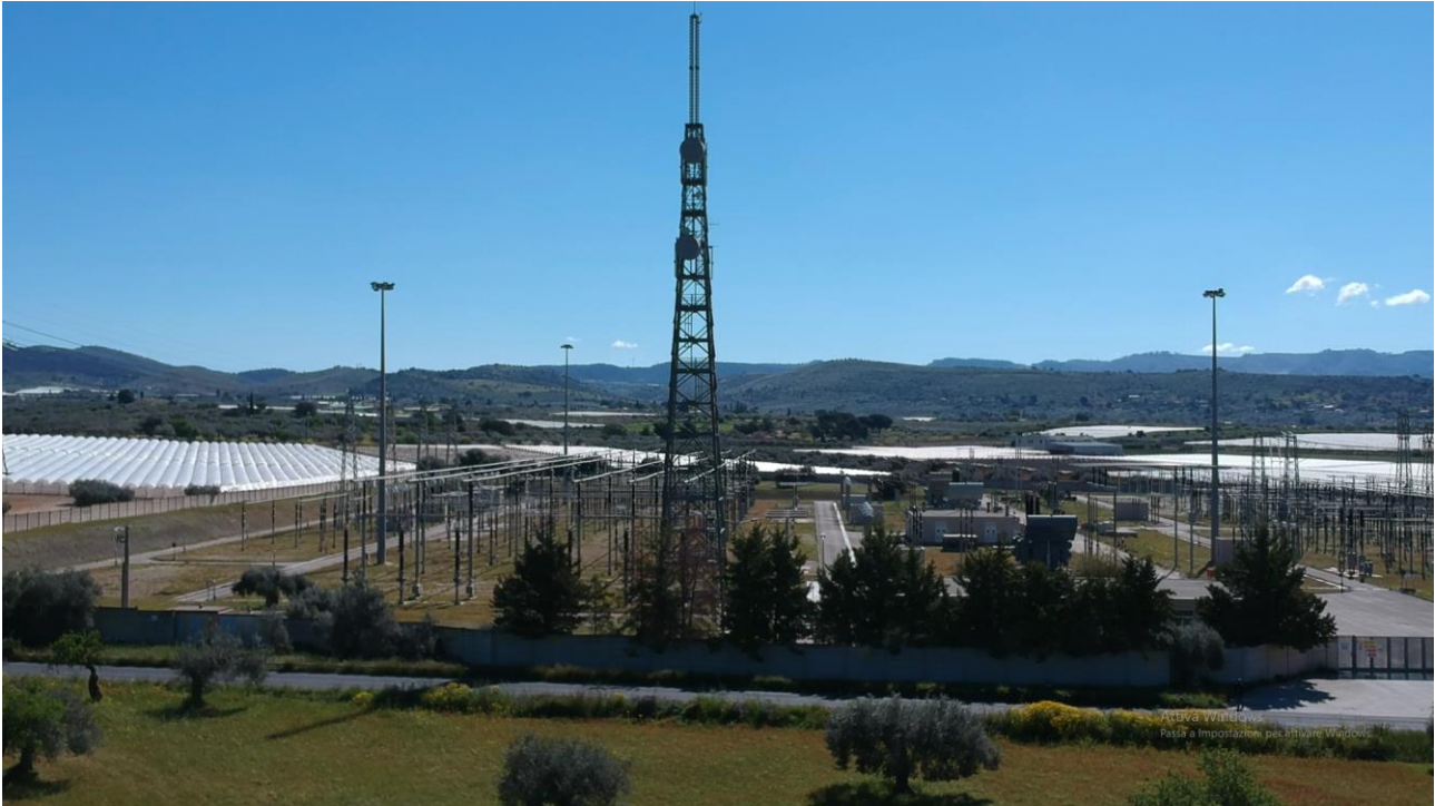
Figura 9 – Stazione elettrica di Chiaramonte Gulfi.
