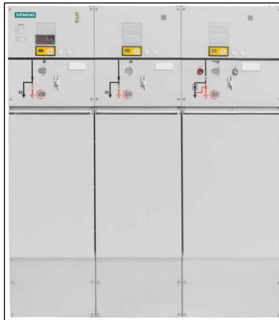
Figura 9 - Vista del quadro elettrico in MT
