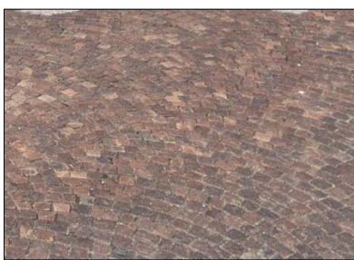
pavimentazione in cubetti di porfido su ponte SS 19
