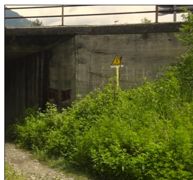
Muro scatolare a grezzo con mascheratura tramite rilevato in terra e vegetazione
