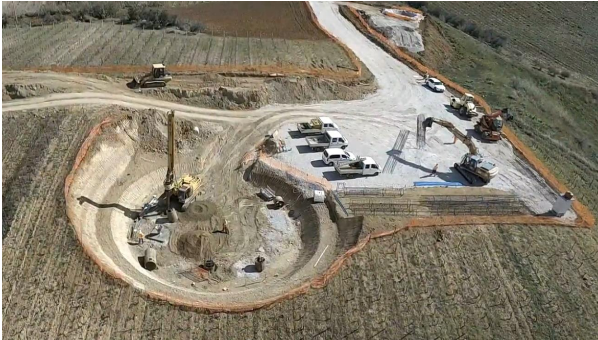
Figura 3.47: Piazzola per lo stazionamento dei mezzi e scavo di sbancamento per il plinto
