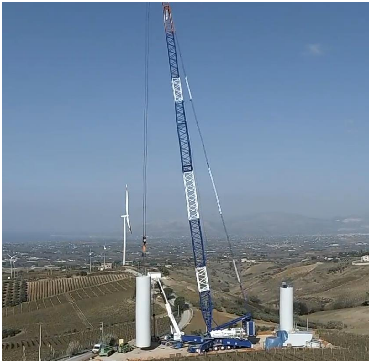
Figura 3.53: Collocazione in opera degli elementi troncoconici in acciaio costituenti il sostegno dell'aerogeneratore
