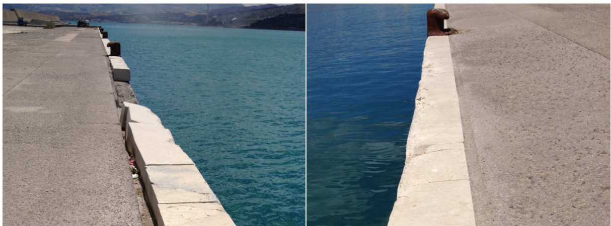
Figura 2.7 – Banchina del molo di sopraflutto: orlatura rovinata o sconnessa
