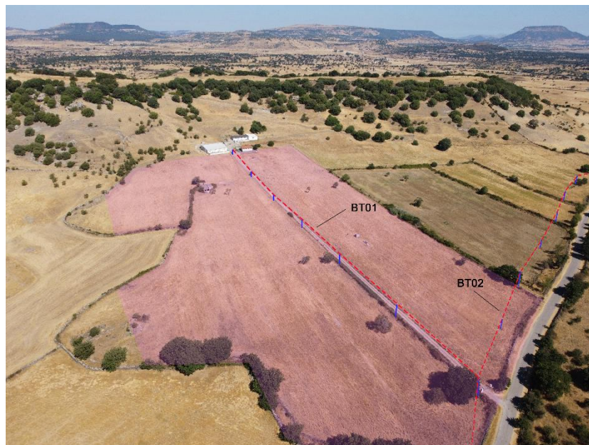
Figura 3.3 Linea aerea di bassa tensione BT01 – BT02 (segnalate in rosso)
