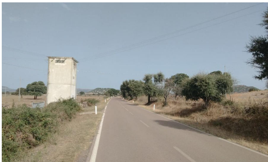
Figura 4.8 Linea aerea di bassa tensione BT06
