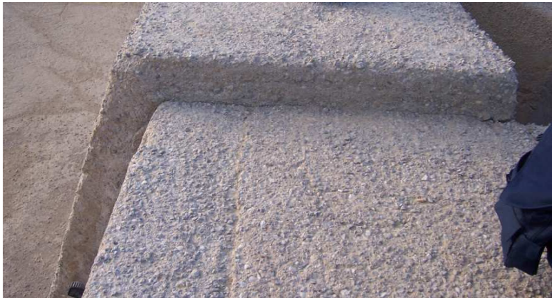
Figura 3.2. Discontinuità presente nel muro paraonde.
