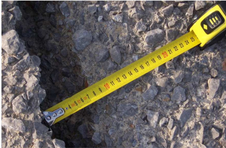
Figura 3.1. Particolare di una discontinuità presente nel muro paraonde.
