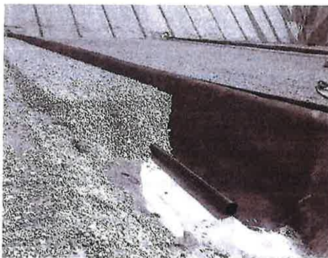
Fig. 9: Tubazione drenaggio percolato
