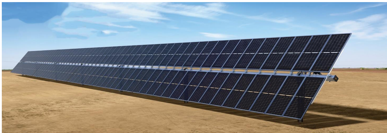
Figura 16: trackers tipo con pannelli installati.
