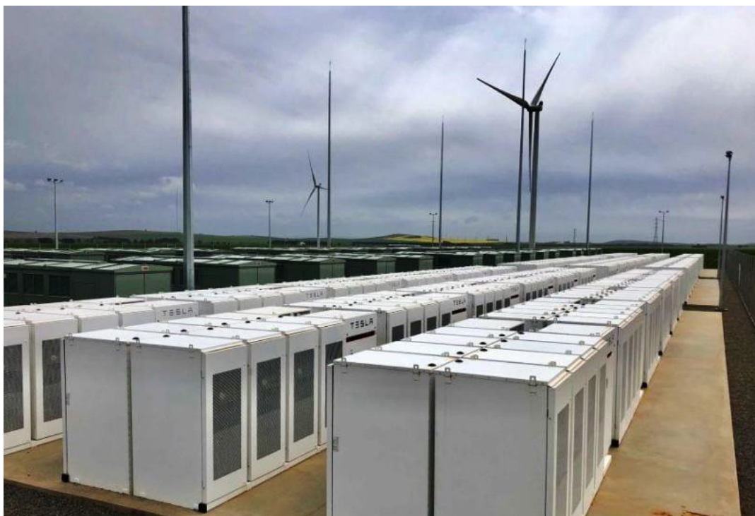
Sistema tipo di accumulo
